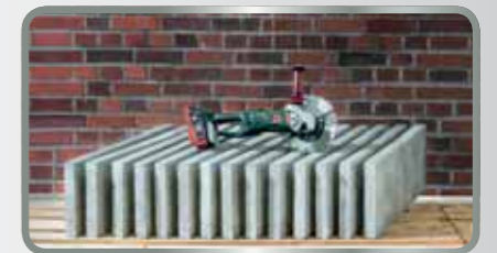
Más de 5 m de cortes: placas de hormigón Material: hormigón
