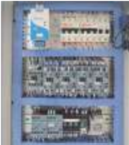
Caja eléctrica · Fuente de alimentación de 24 V. · Todos los contactores y relés SIEMENS o Schneider.
