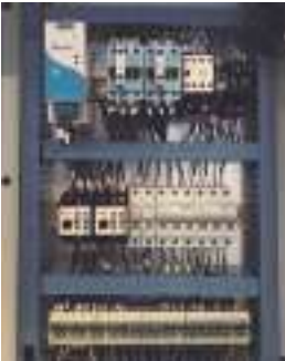
Caja eléctrica · Fuente de alimentación de 24 V. · Todos los contactores y relés SIEMENS o Schneider.
